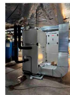
EQUIPO DEPRESIÓN RECUPERACIÓN ENERGÍA CON AGUA FRÍA
