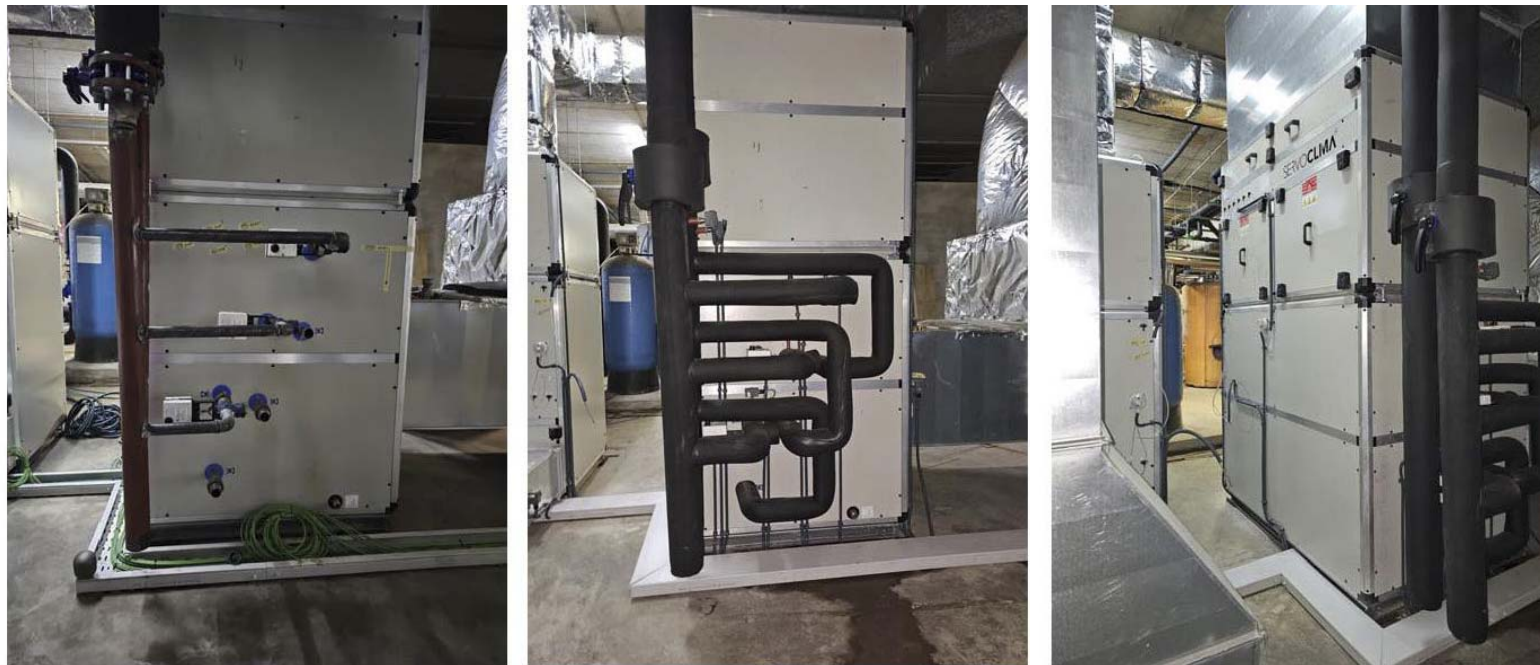
Equipo deshumectación con agua fría CL-02.
